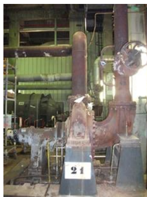
Figure 2 – La pompe Booster à la centrale thermique de Martigues
